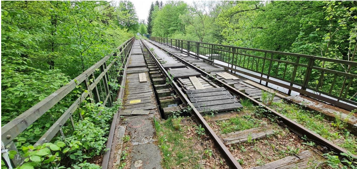
Abbildung 36: Brücke Wilhelmsthal I, die nach der Streckenbegehung in der Zwischenzeit saniert wurde
