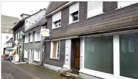
- vernachlässigte Gebäude / Fassaden verschlechtern das Straßenbild
